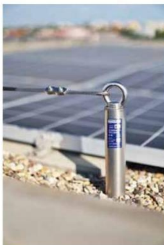
Detail kotvicího bodu pro upevnění ocelového záchranného lana proti pádu osob ze střechy. Roofix
